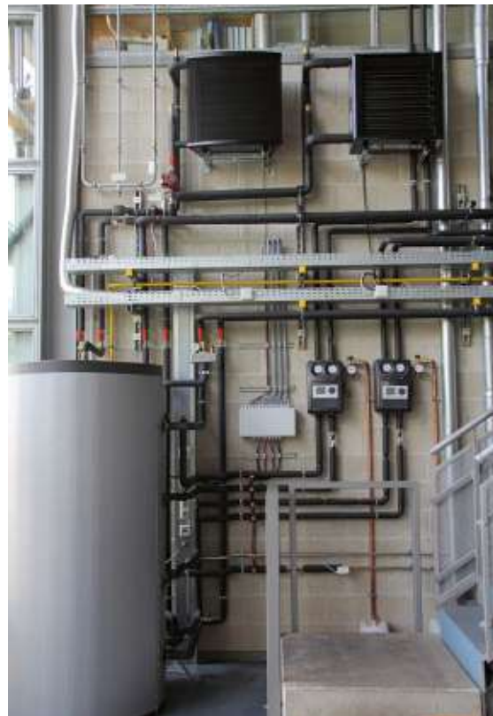
Abbildung 5: Hydraulische Installation mit thermischen Speicher, Wärmesenke und Solarthermiesteuerungen
