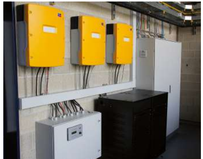
Abbildung 2: Inselnetzwechselrichter und elektrischer Energiespeicher
