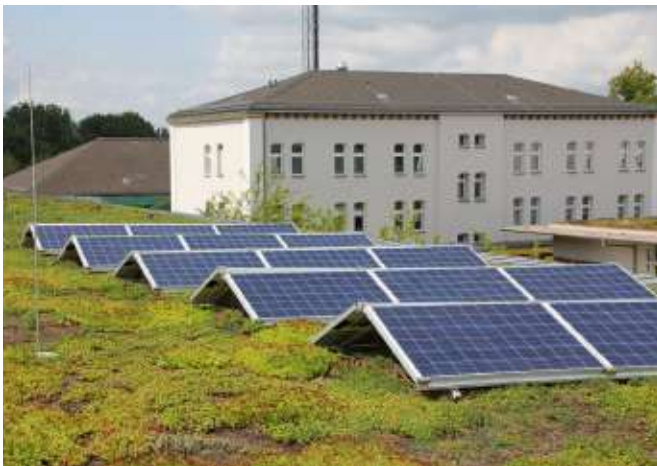
Abbildung 3: Photovoltaikgenerator in Ost-West-Ausrichtung auf dem Flachdach der OTH Amberg
